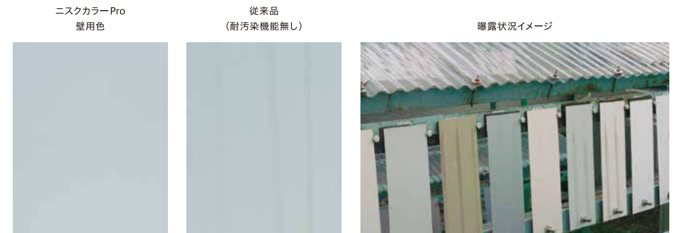
耐汚染機能の有無を比較した写真。右の写真には雨筋汚れがついている
